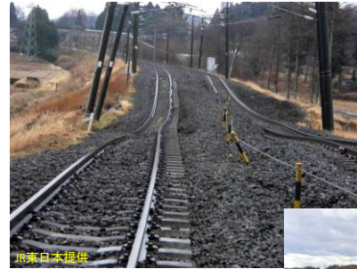
東日本大震災(2011年3月11日) JR東北線(泉崎～矢吹)の 盛土被害
