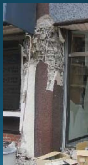
損傷度Vの柱
